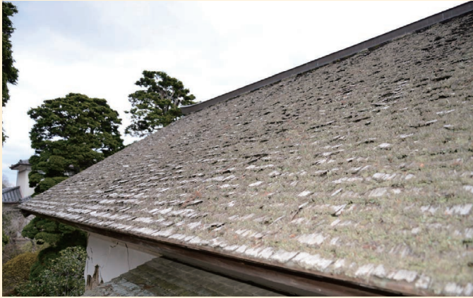
修理前の前葺屋根。葺いてから40年が経過し、こけら板は薄くポロポロになり、苔むしていた。
