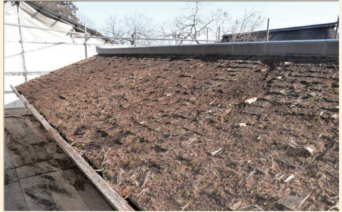
修理前の板葺屋根。葺いてから20年だが、付近の杉の枝葉が積もり、板の原形を留めないほどに腐朽が進んでいた。
